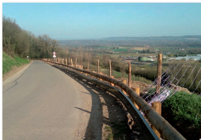
Mont de la Calique, pose de clôtures avec Campagne Services © M. LOQUET.
