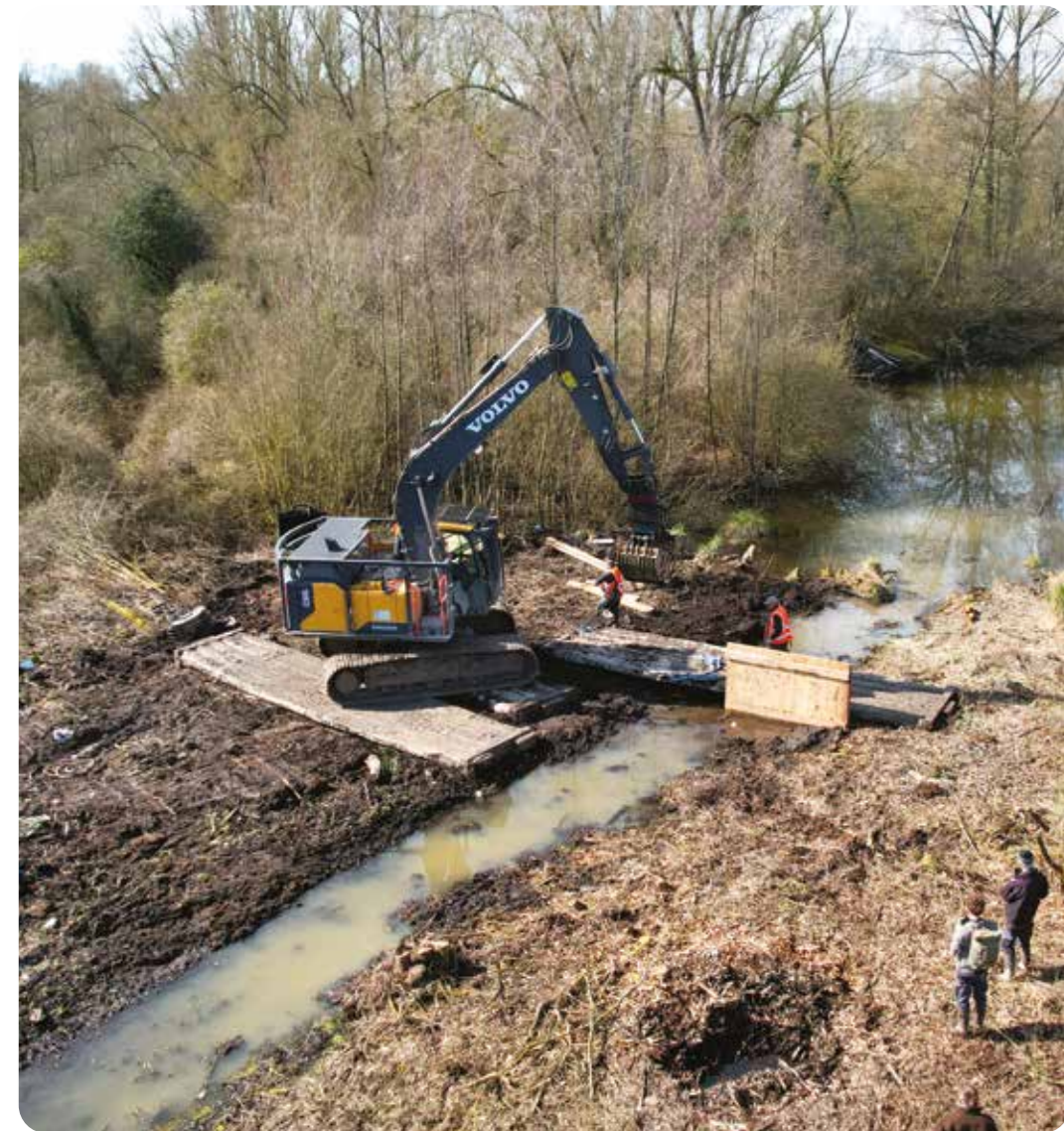
Bouchage d'un drain par la mise en place d'un seuil afin de maintenir les niveaux d'eau dans le marais
